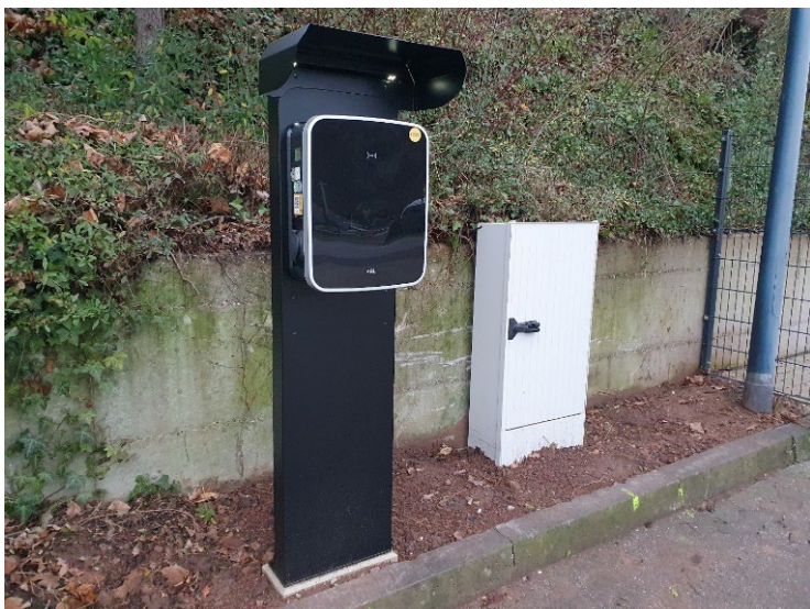
Abbildung 2: Öffentliche Ladestation in Form einer Wallbox (2x 11 kW) mit Standfuß und Zählermessschrank in der Ortsgemeinde Bullay
