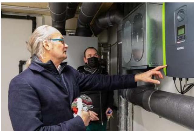
Minister Turmes im (Vordergrund) ließ sich das energetische Konzept für die Einfamilienhäuser vom leitenden Ingenieur für nachhaltige Entwicklung der SNHBM, Julien Bertucci (hinten), im Detail erläutern. Foto: ARGE SOLAR
